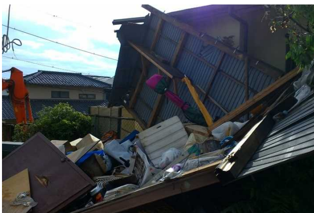
① 倒壊した物置 （東方向から撮影）
