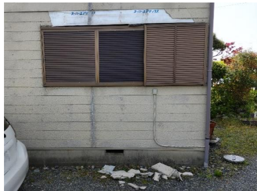
④住家外壁材の一部破損（東から西へ撮影）
