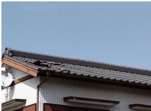
③住家屋根瓦の浮き上がり（南西から北東へ撮影）
