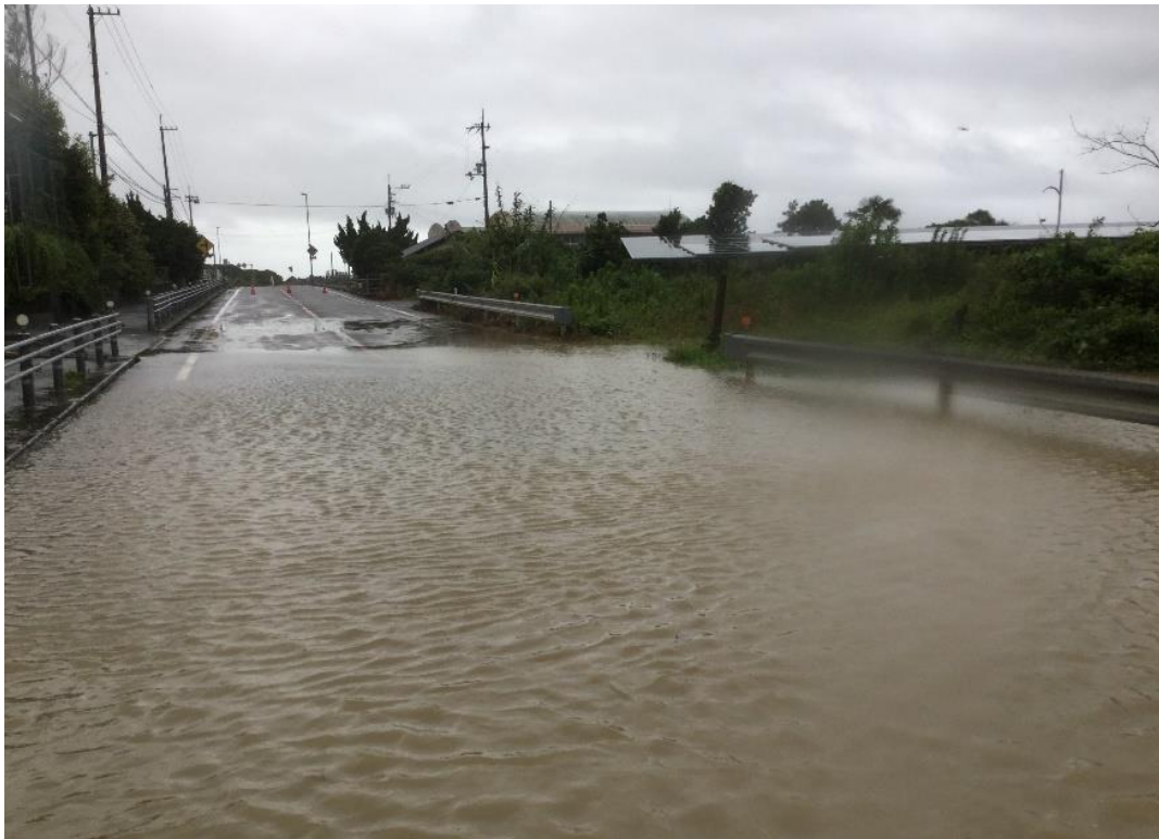
令和元年7月 冠水(国道55号 室戸市)
