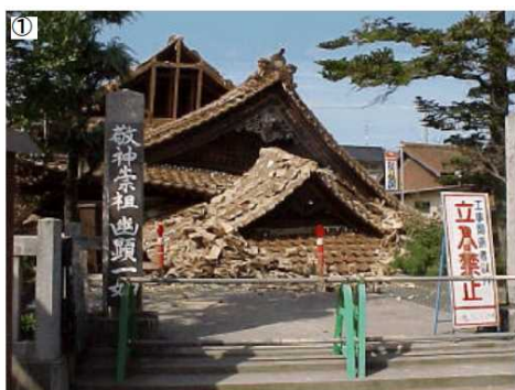
写真 境港市上道町 出雲神社上道協会の南側半分が倒壊
