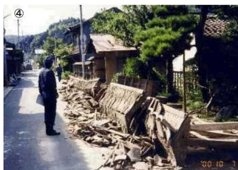
写真 日野町黒坂 民家外壁の倒壊
