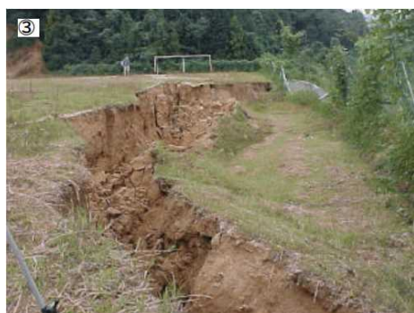
写真 西伯町（現 南部町）法勝寺 法勝寺中学校グラウンドの地割れ
