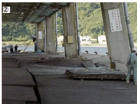
写真 境港市境港漁港 液状化により漁港施設に被害
