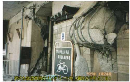
写真 砕けた鉄道高架のコンクリート柱（神戸市灘区）
