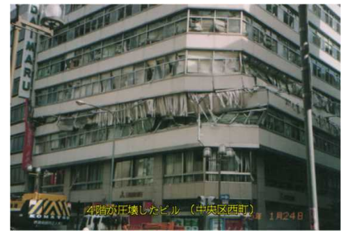
写真 4階が圧壊したビル（神戸市中央区）
