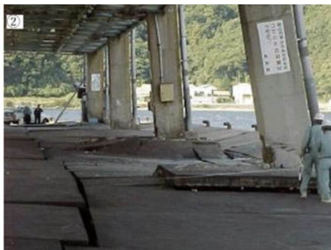
図 2 液状化の被害写真（平成 12 年 10 月 地震・火山月報（防災編））
