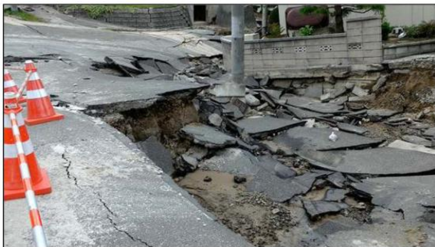
図3 液状化の被害写真（平成30年9月 地震・火山月報（防災編））
