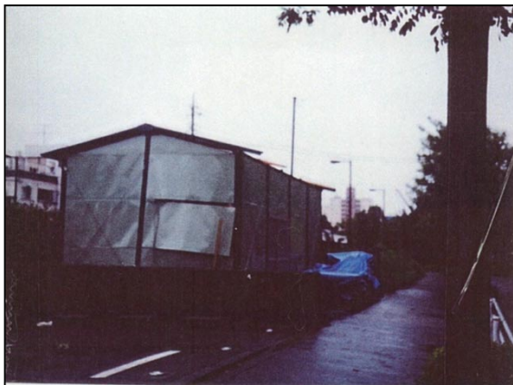
写真11（多摩市 落合地区） プレハブの倉庫が破損。屋根がなくなっている。 （写真提供：多摩市役所）
