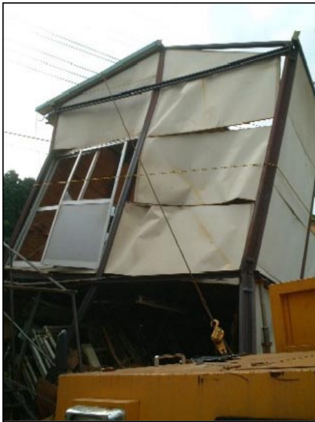
写真7（八王子市 東中野地区） プレハブ全壊。西側へ傾く。
