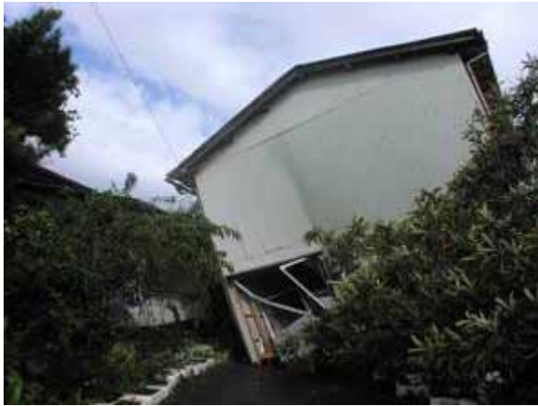
5. 倉庫倒壊南方面から
