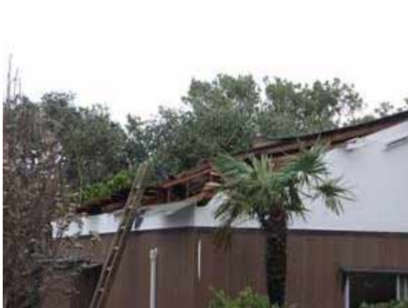
3. 民宿屋根一部損壊
