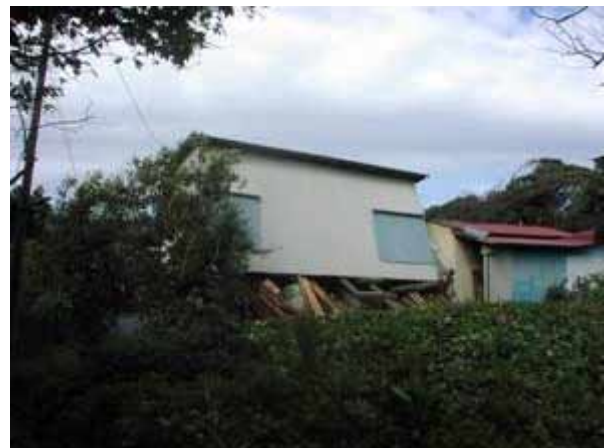
4. 倉庫倒壊東方向から
