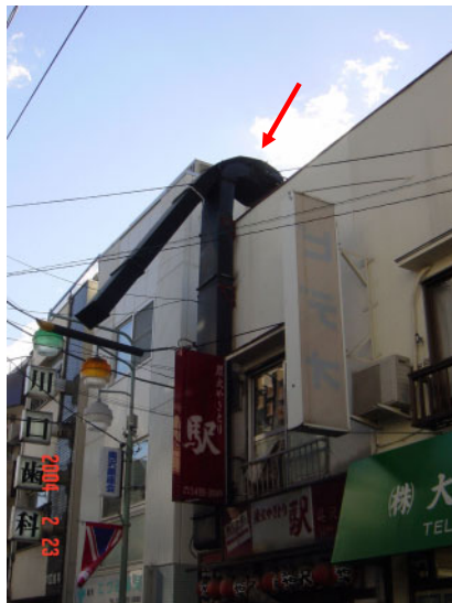
B 折れた排気ダクト (矢印のところで折れた)
