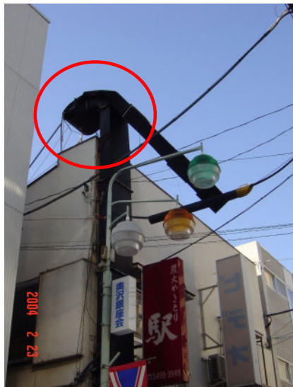
A 折れた排気ダクト
