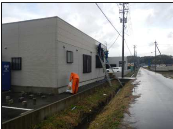
外壁がはがれた非住家 (南から撮影)
