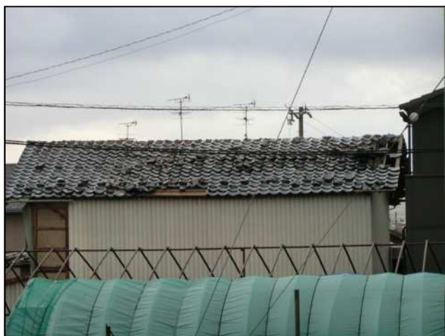
屋根瓦のめくれや落下、外壁が一部損壊した納屋 【東方向撮影】
