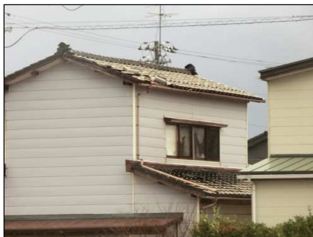
屋根瓦がめくれ、落下した住家 【北東方向撮影】
