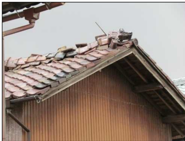
屋根瓦がめくれ、落下した住家 【南東方向撮影】
