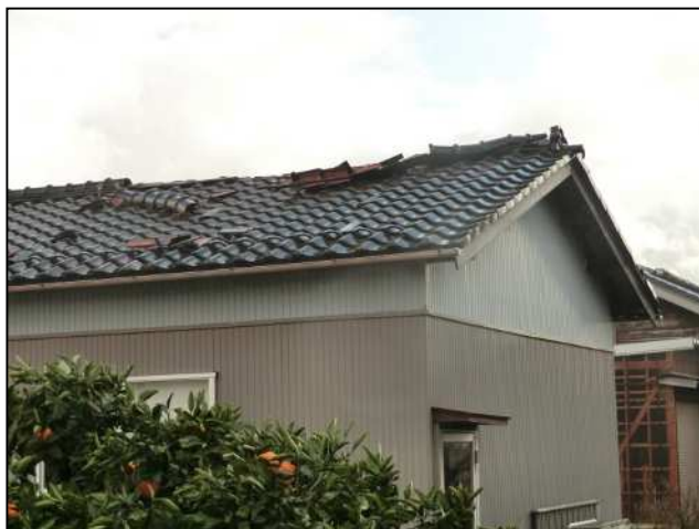
屋根瓦がめくれ、落下した車庫 【南東方向撮影】
