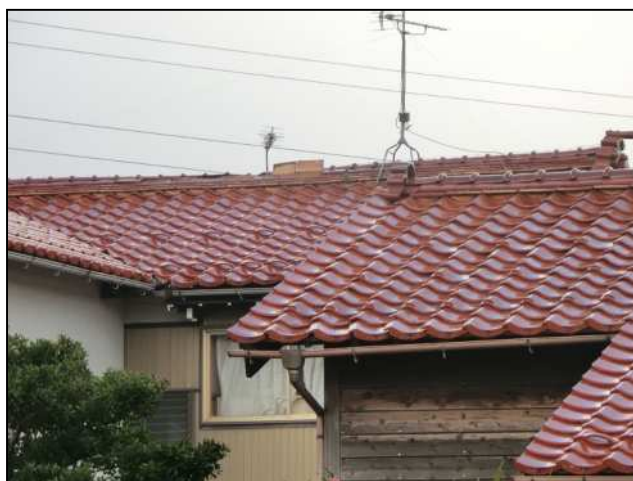
屋根瓦の一部がめくれた住家 【北方向撮影】
