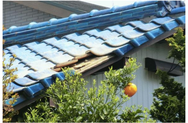
② 屋根瓦が落下した住家
