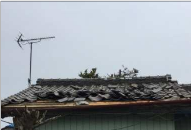
屋根瓦がめくれた住家 （北から撮影）
