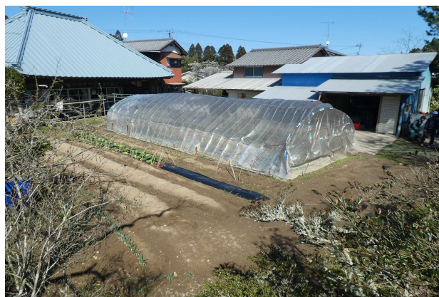
⑤ 鋼管が変形したビニールハウス (南西方向から撮影)
