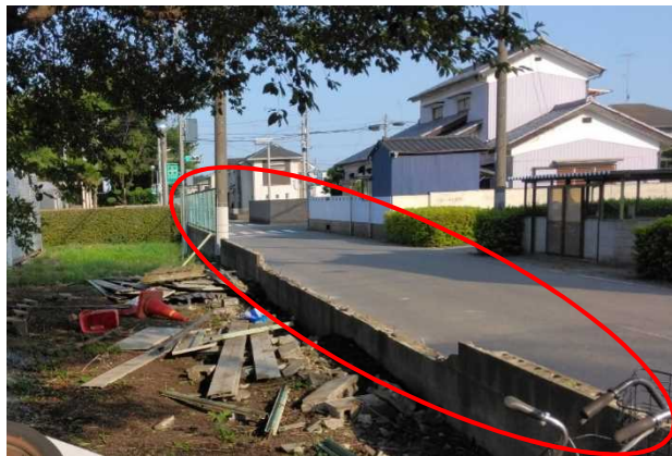
④ 倒れたフェンス (北方向から撮影)
