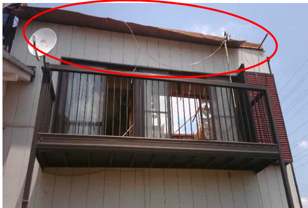
① 屋根の小屋組が飛散した住家 (南西方向から撮影)
