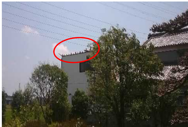
② 屋根の小屋組が飛散した住家 (北方向から撮影)
