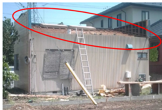
⑤ 屋根の野地板が飛散した住家 (北方向から撮影)
