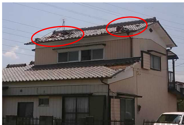
③ 屋根瓦が飛散した住家 (北方向から撮影)
