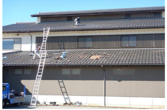
② 瓦が飛散した屋根 (東方向から撮影)
