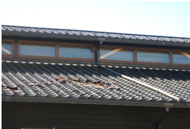
③ 瓦が飛散した屋根 (北東方向から撮影)
