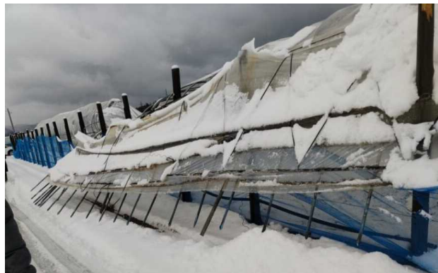
② 鋼管が変形した農業用ハウス (東方向から撮影)
