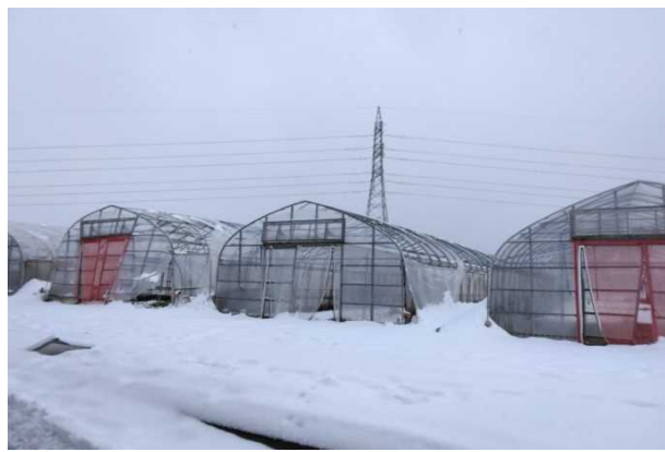
④ ビニールがはく離した農業用ハウス (東方向から撮影)
