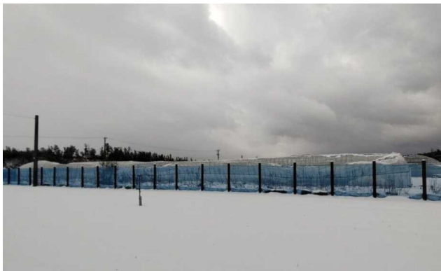
① 農業用ハウスの変形 (北方向から撮影)
