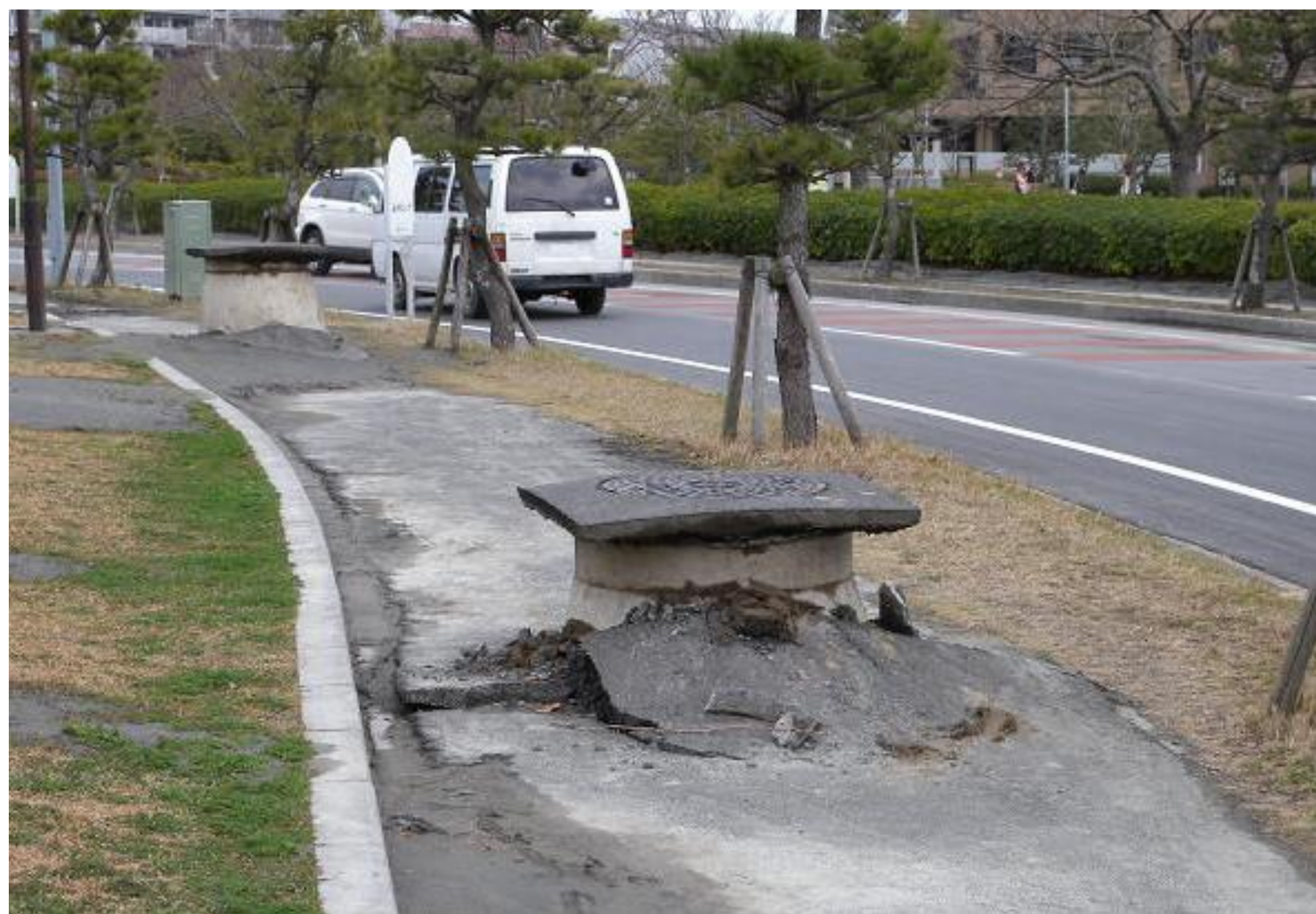
マンホールのうきあがり(千葉県浦安市) 出典：気象庁（東北地方太平洋沖地震現地調査）
