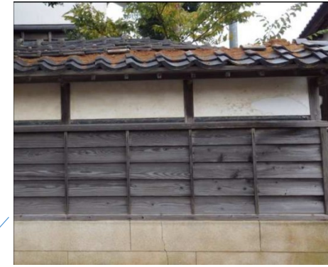
鳥取市青谷町青谷: 住家の瓦落下、壁のひび
