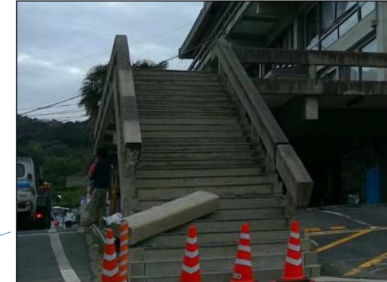
倉吉市葵町: 市役所のコンクリート製手すりの落下
