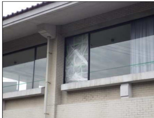
北栄町由良宿: 商会議所の窓ガラス割れ
