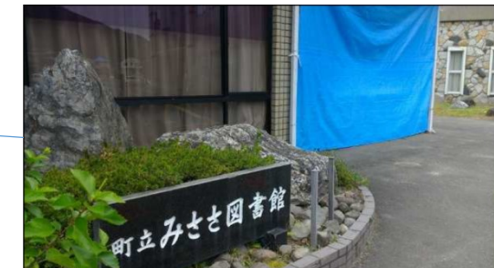
三朝町大瀬: 図書館の窓ガラス割れ(ブルーシート部分)
