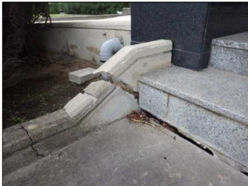
北栄町土下: 建物基礎部分の亀裂
