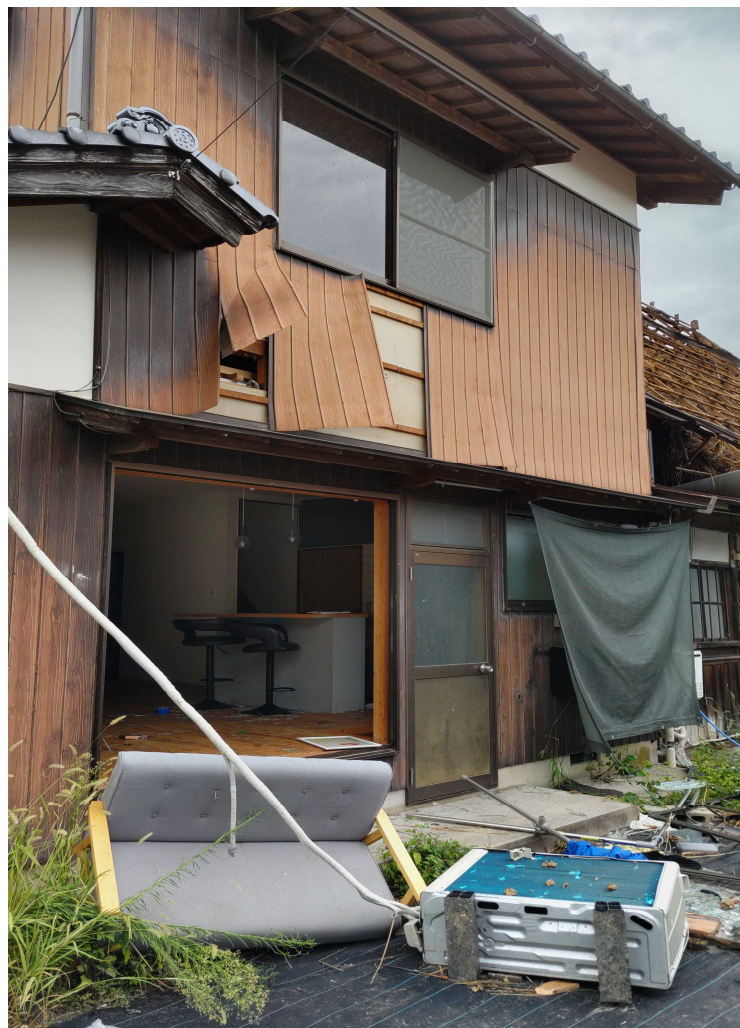
写真④ 外壁材がはく離した 木造住家
