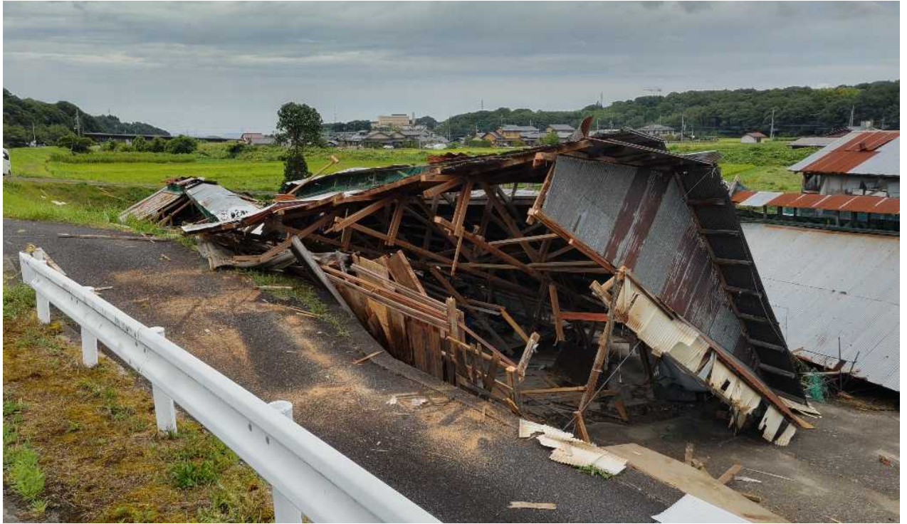
写真③ 倒壊した旧鶏舎
