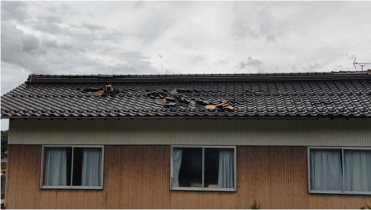
写真① 瓦のめくれた木造住家
