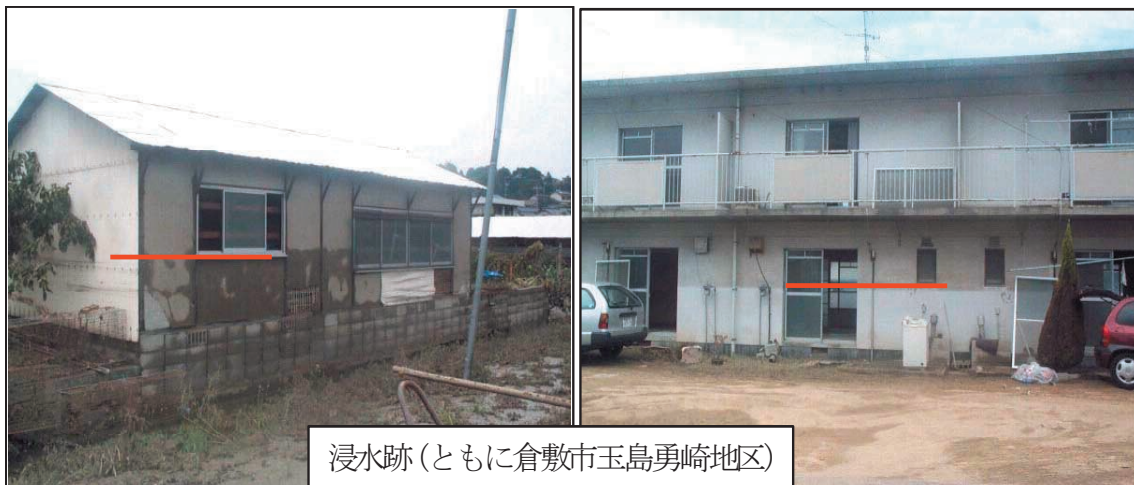
写真2.3.2.2 岡山県倉敷市の浸水跡「赤いラインまで浸水」
