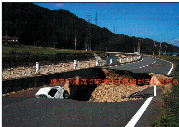
写真 2.6.3.4 出石町上村 洗掘で陥没した道路に車ごと落下。
