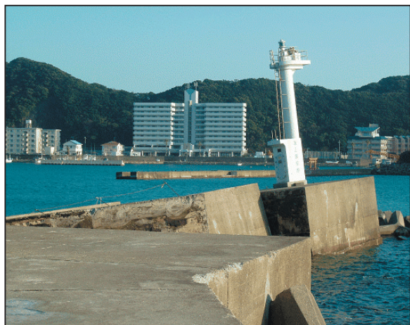
写真 2.6.3.11 西牟婁郡さみ町周参見漁港 約48mにわたり湾内に向けて傾いた防波堤と灯台。
