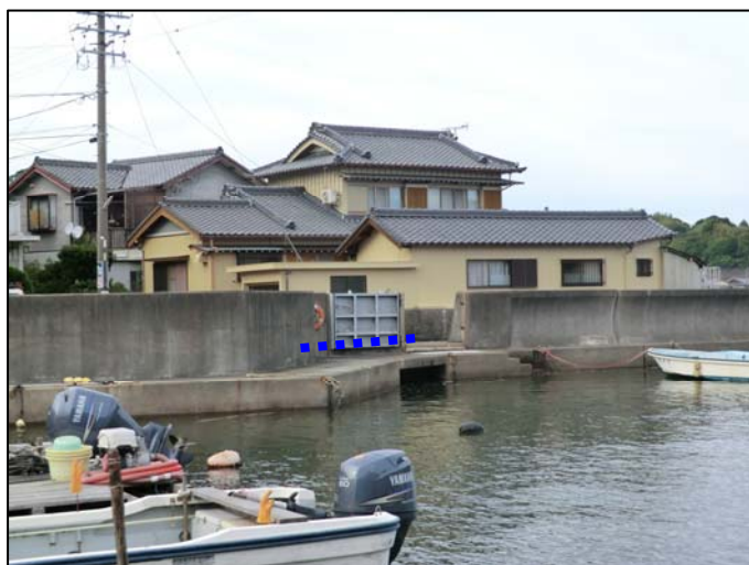
⑤防潮堤の浸水痕跡 [磯部町三ヶ所]
