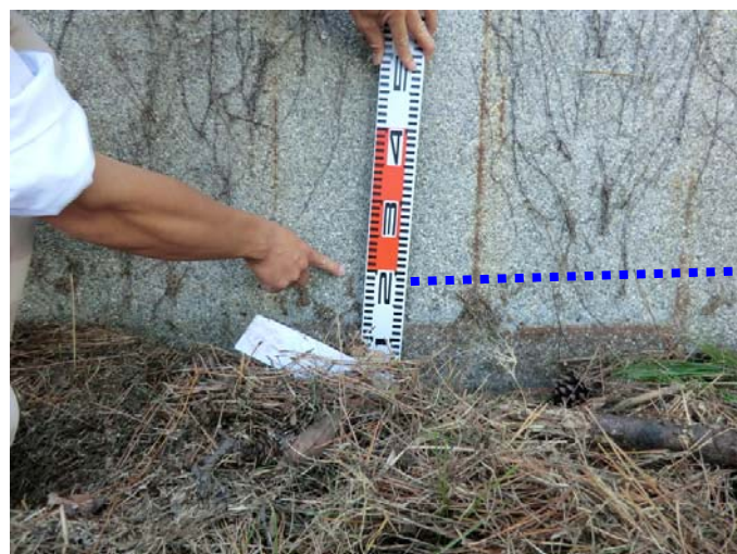
④浸水痕跡 約 0.2m (地上高)
