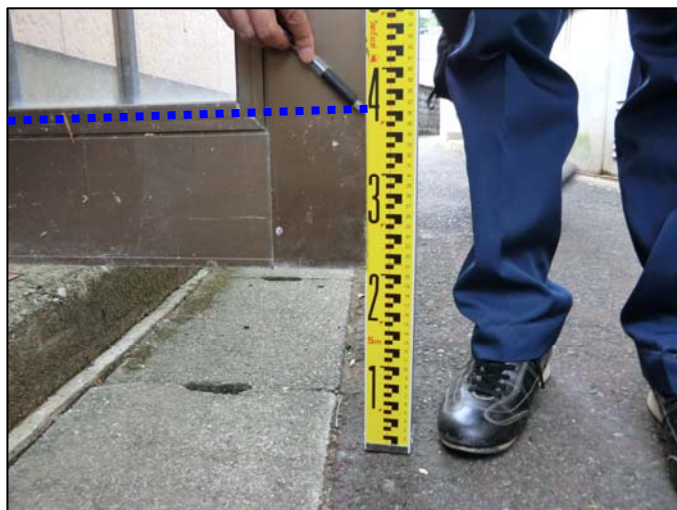
④浸水痕跡 約 0.4m (地上高) [磯部町渡鹿野]
