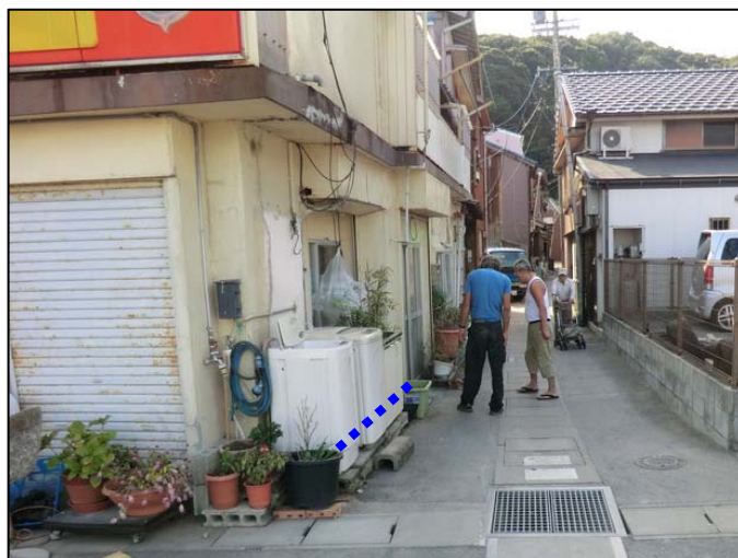
④浸水痕跡 [小浜町]
