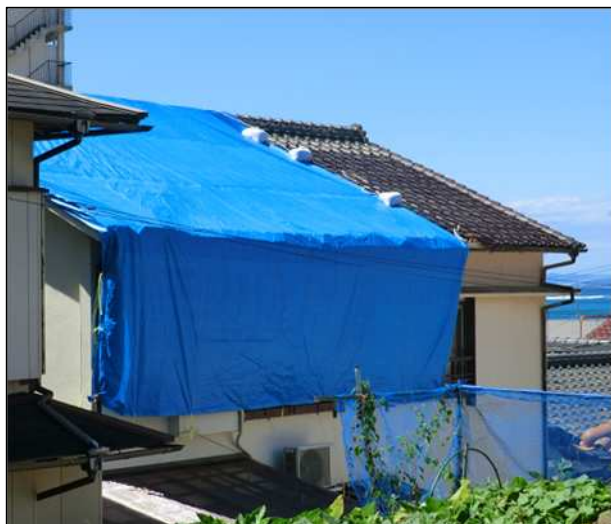
屋根瓦が30枚以上落下したため ブルーシートで覆われた住家
