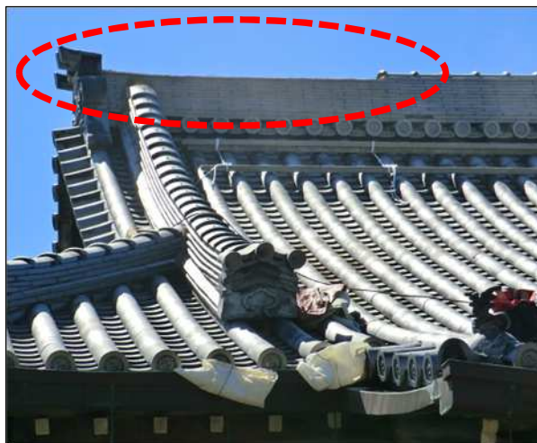
屋根瓦の一部(赤点線部分)が めくれた寺院
