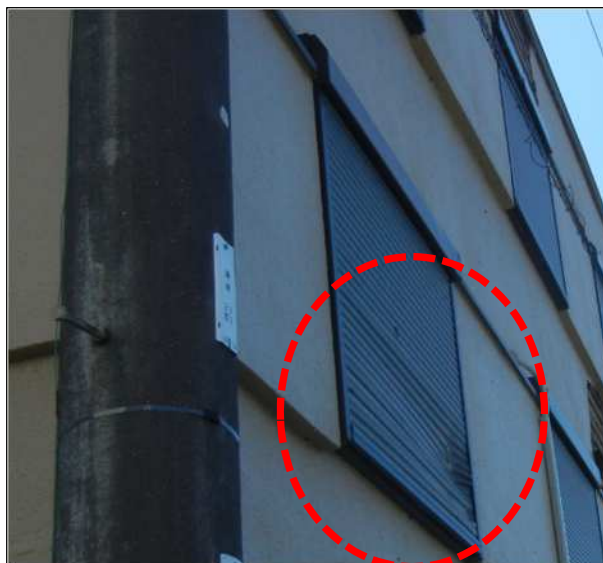
雨戸(赤点線部分)の変形した住家 ( の外壁破損と同じ壁面)
