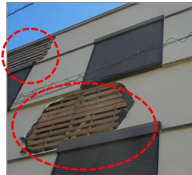
外壁(赤点線部分)が2か所破損した住家
