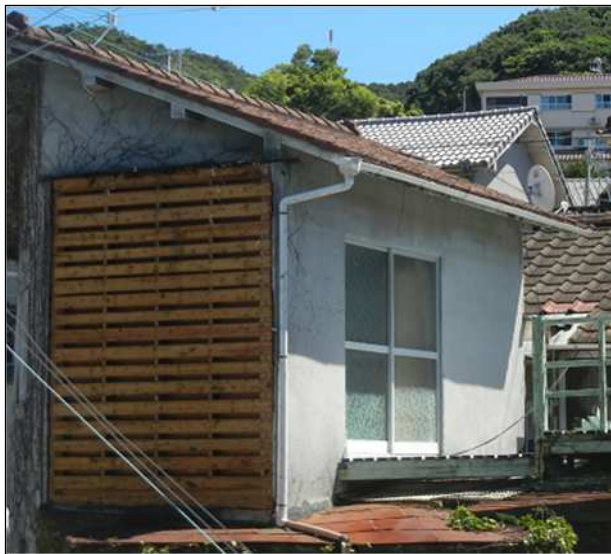
外壁が破損した住家
