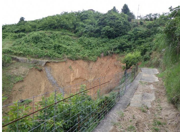
被災した農道（九度山町）
