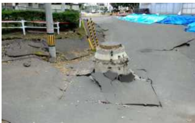
マンホール周辺の道路の陥没
