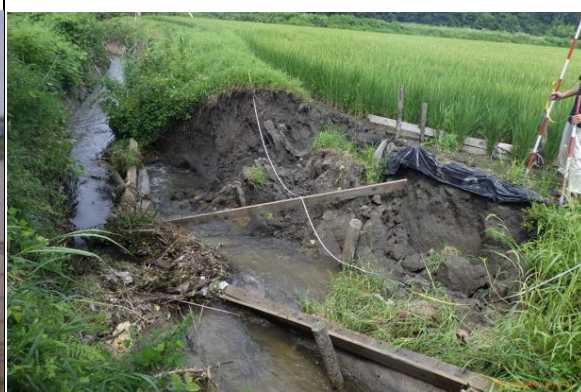
水路法面崩落（長井市中伊佐沢）
