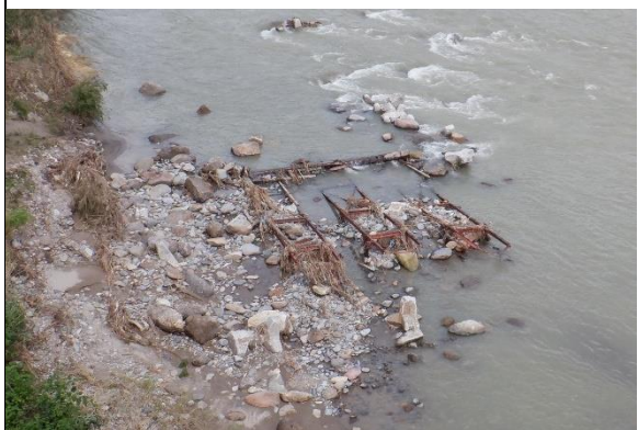
増水による築の崩壊（舟形町一の関）
